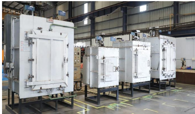
Gambar 1. furnace untuk proses pembakaran
